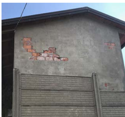
Figura 15 – Intonaco ammalorato settore loculi n°1
