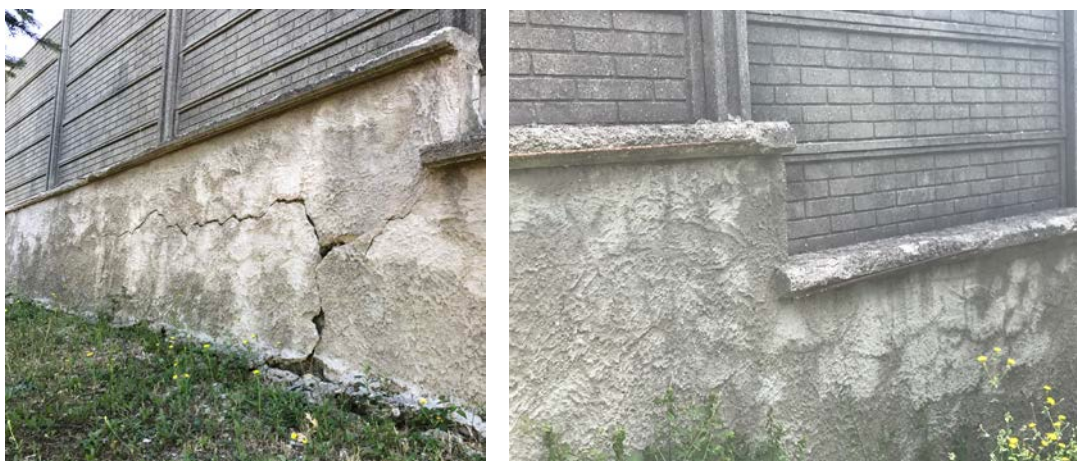
Figura 14 - Intonaco muro perimetrale e copertine ammalorate
