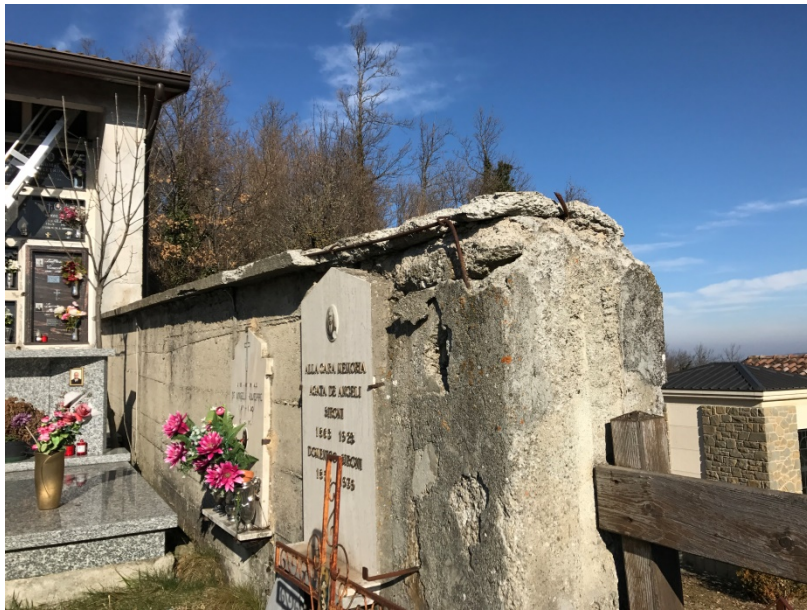
Figura 2 – Rottura ed espulsione del copriferro della copertina sommitale del muro di contenimento
