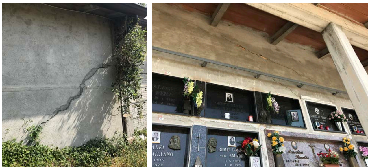
Figura 16 – Lesioni settore loculi n°1
