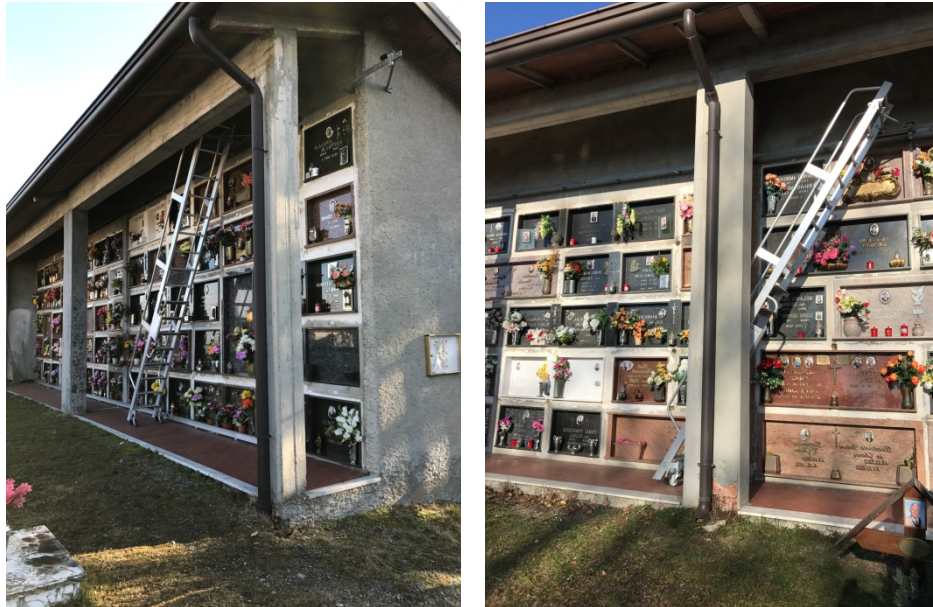
Figura 12 – Pluviali non regimati
