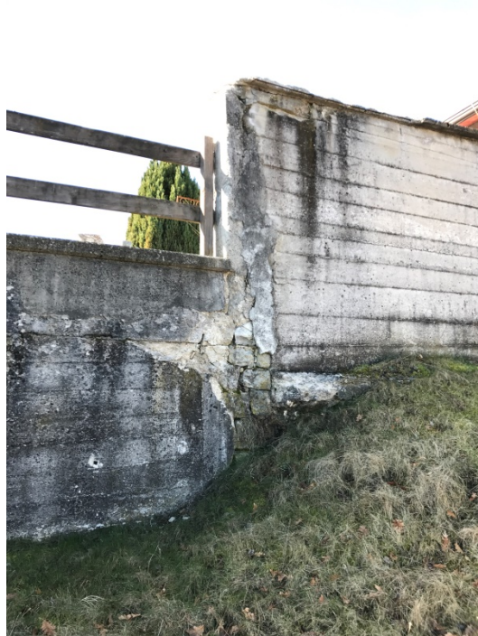
Figura 3 – Ammaloramenti diffusi nel muro di contenimento
