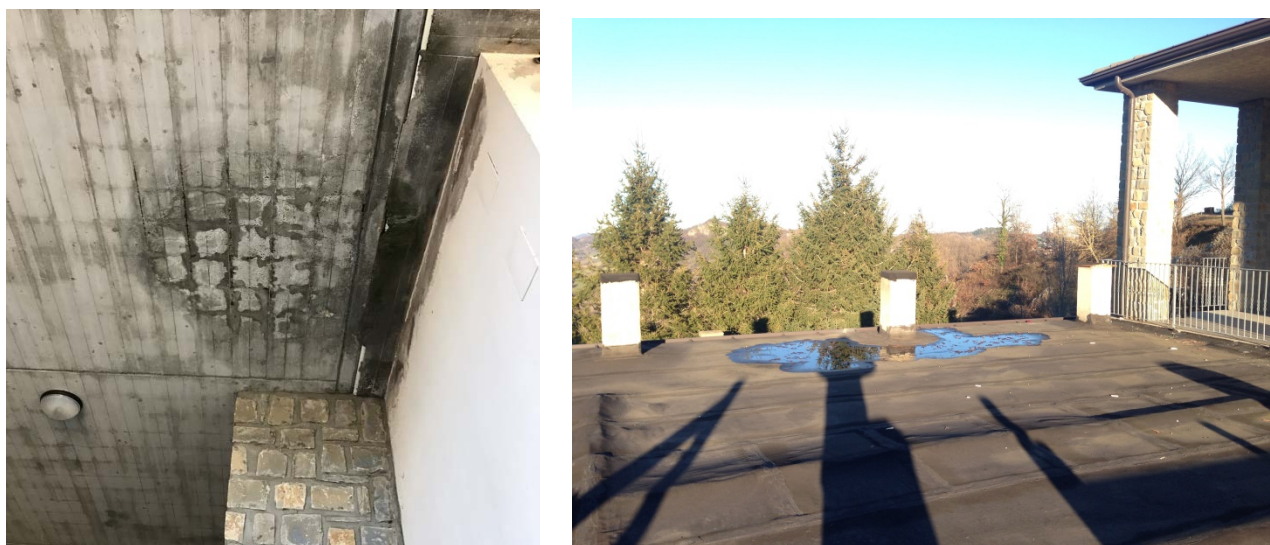
Figura 6 – Infiltrazioni di acqua meteorica nella struttura di copertura settore loculi n°6
