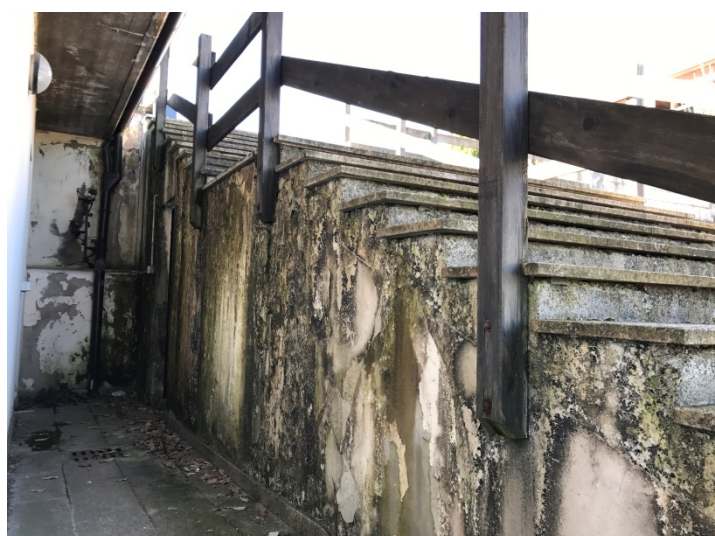
Figura 5 – Ammaloramento e distacchi diffusi di intonaco lungo la struttura della scalinata
